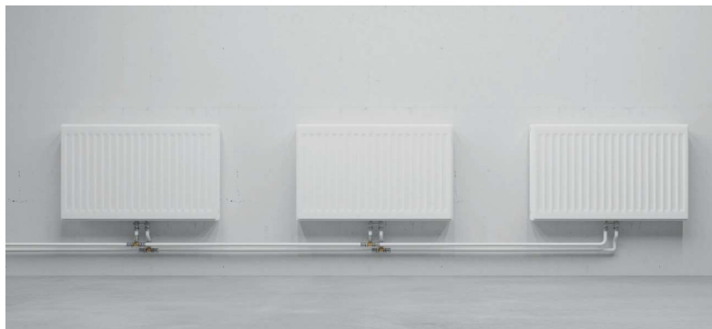
46.att.: Divu cauruļu apkures radiatori.
