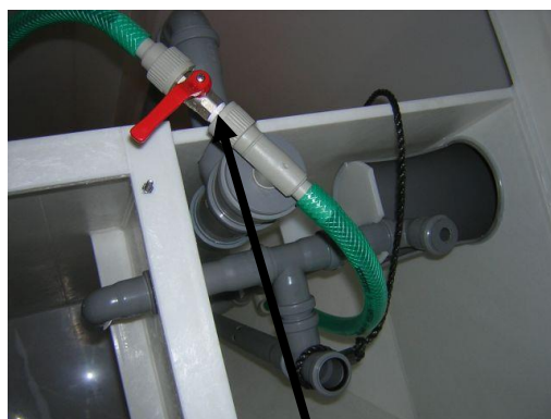
Vārsts aeroliftam II – izslēgtā pozīcijā „OFF” iekārtas normālas darbības laikā
