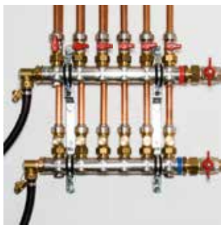
Radiatoru un paneļu apkures sistēmas
